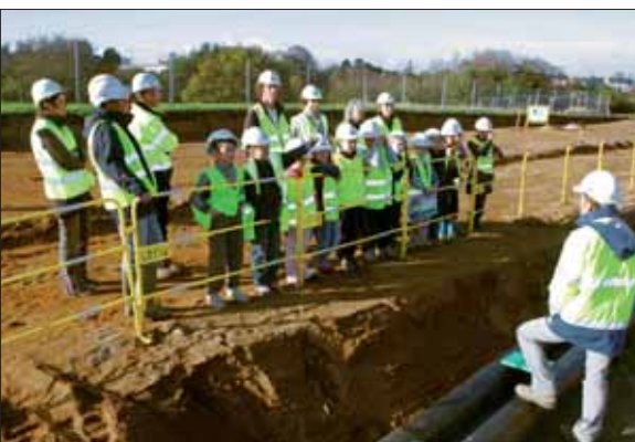
Les écoliers de la Vallée ont découvert le réseau d'eau des futurs logements de la plaine.
